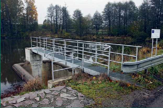
1. Nevhodné řešení. Tzv. sdružený bezpečnostní objekt vytváří ve většině případů pro vydru nepřekonatelnou bariéru.
