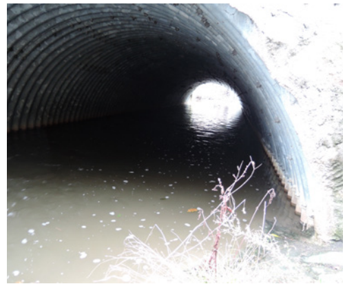
31. Detail nevhovujícího mostu přes Hamerský potok.
