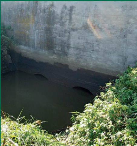
1. Nevhodné řešení. Propustky, u kterých voda přesahuje třetinu jejich průřezu, jsou pro vydru většinou neprůchozí.
