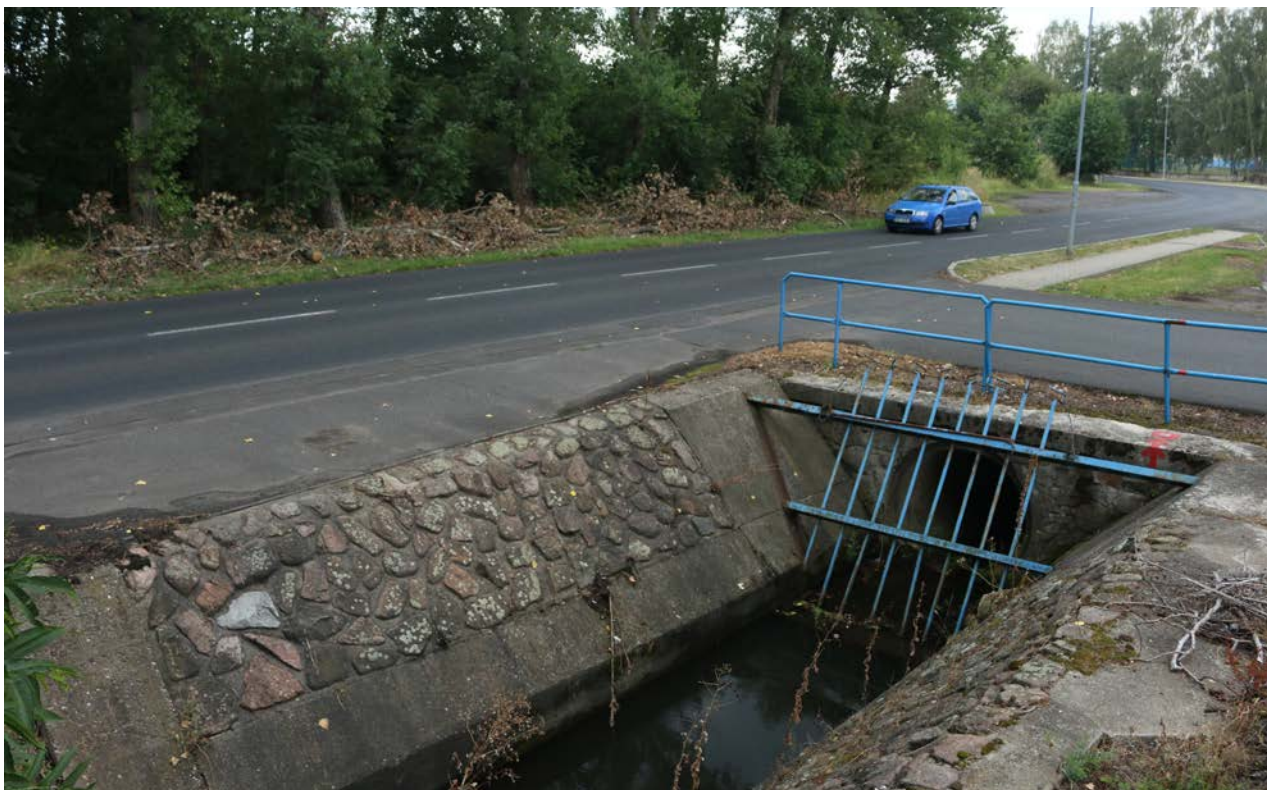
Obr. 17. Sviní potok u obce Košťany je v délce 380 metrů sveden do podzemního kanálu. Pro vydry je to bariéra, kterou pokud se snaží překonat, dostanou se na silnici a do intravilánu obce. Je to tedy velmi nebezpečné místo (foto Kateřina Poledníková); Fig. 17. The Sviní stream near the village of Košťany is drained into an underground canal in the length of 380 meters. For otters, it is a barrier that, if they try to overcome, they get on the road and into the village. So it is a very dangerous place (photo by Kateřina Poledníková)
