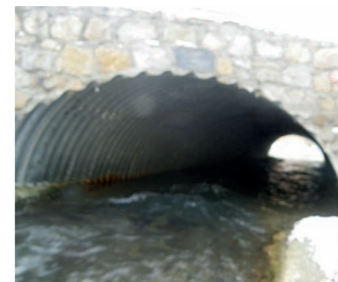
31. Detail nevhovujícího mostu přes Hamerský potok.
