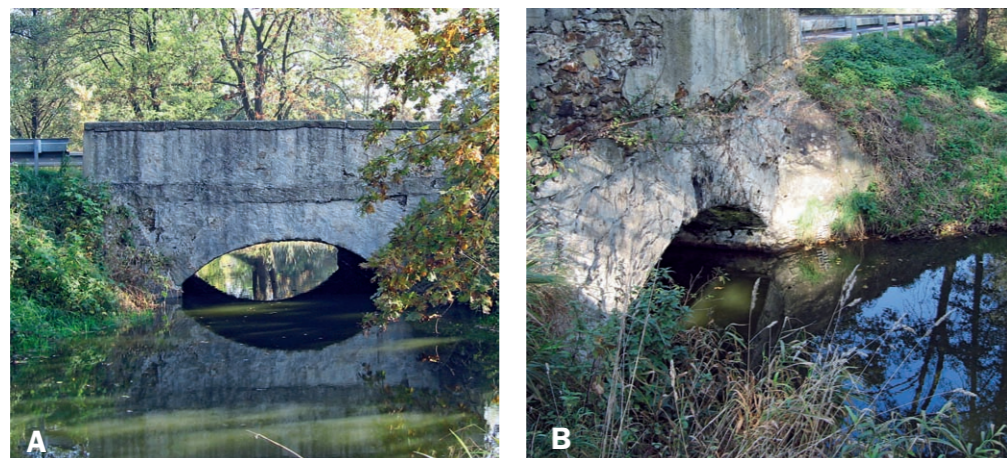
28. Fotografie špatně průchodného mostu na Zlaté stoce.
