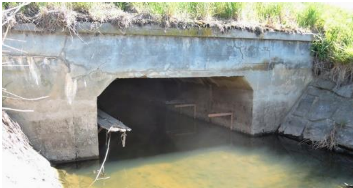
Obr. 6 Torzo dřevěných lávek v propustku Lomnice nad Lužnicí 2, které zde byly instalovány okolo roku 2000, stav v roce 2016. Kovové konzoly vydržely, ale dřevěná prkna shnila. Fig. 6 Torso of a boards in the Lomnice nad Lužnicí 2 culvert, which were installed here around the year 2000. The picture shows the situation in 2016. The metal consoles survived, but the wooden boards rotted.
