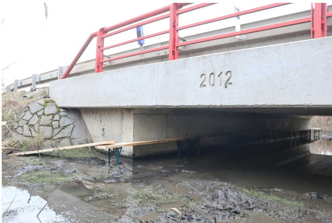
Obr. 10 Lávka instalována na výtoku z Mysliveckého rybníka, silnice č. 27, Ústecký kraj (ID Luční potok 1) Fig. 10 Board installed on channel of Myslivecký pond, road no. 27, Ústí region (ID Luční potok 1)
