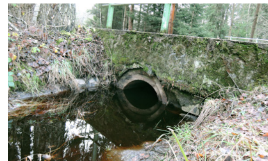
Propustky plné vody či bahna nemohou sloužit jako bezpečný průchod pro zvířata pod silnicí.
